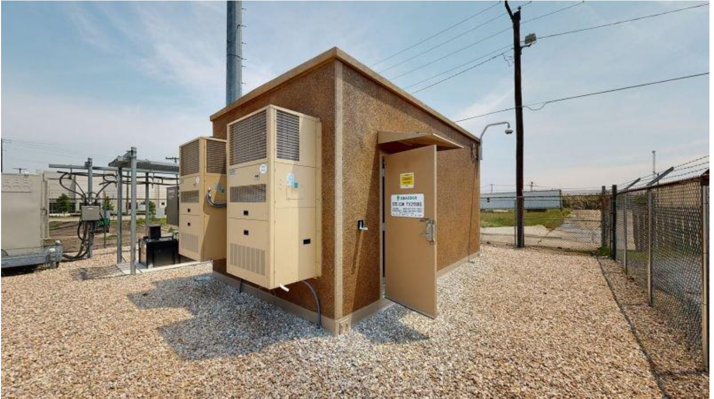
Edge data center in Arlington, Texas
